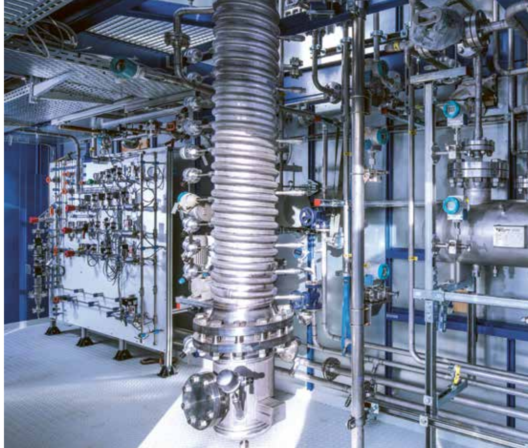
Das Karlsruher Institut für Technologie hat eine Anlage entwickelt, die aus elektrisch hergestelltem Wasserstoff Methan erzeugt.
